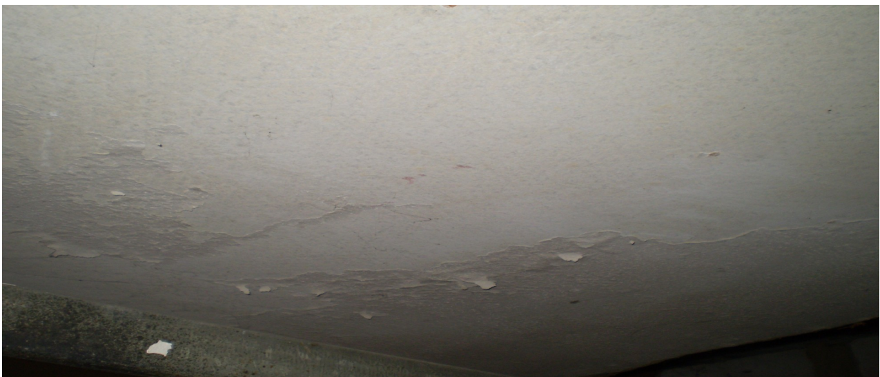
Afbeelding 10.15 Verweerd plafond gemaakt van witte asbest ©
