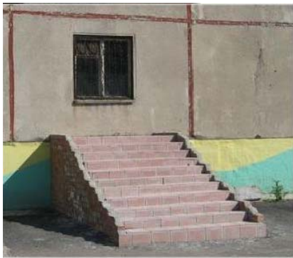
Raam getekend in plaats van een deur
